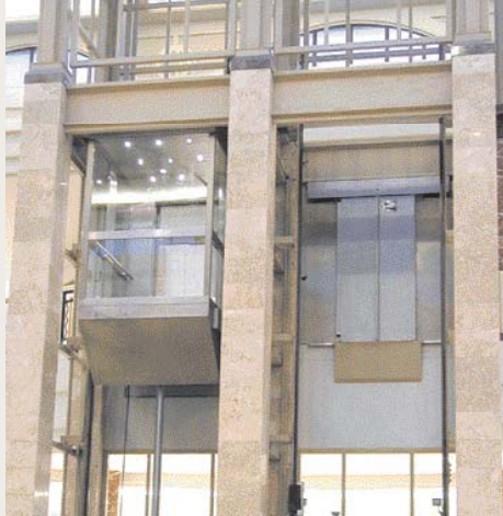
Ascensor en movimiento, con velocidad constante.
